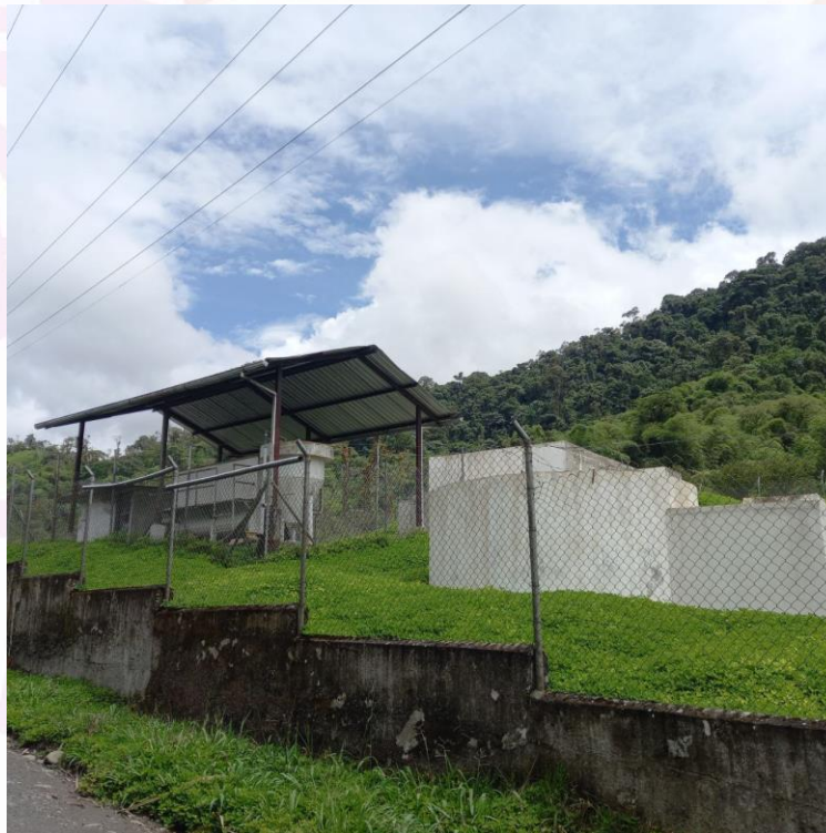
Imagen N° 17 Planta de agua entubada (Agua Potable)
